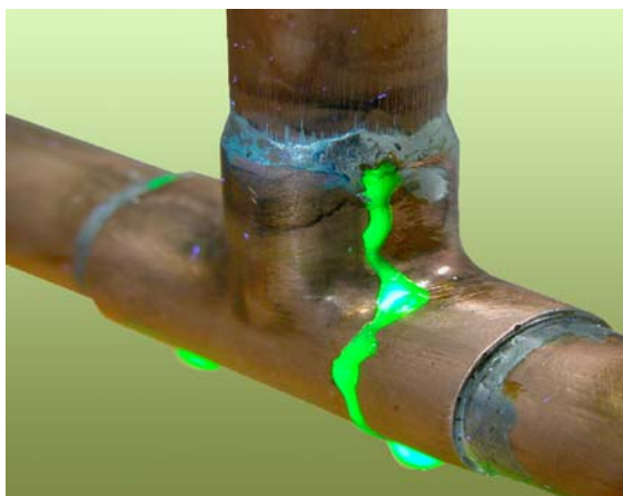
Регистрация утечки в системе охлаждения с помощью флуоресцентного концентрата
